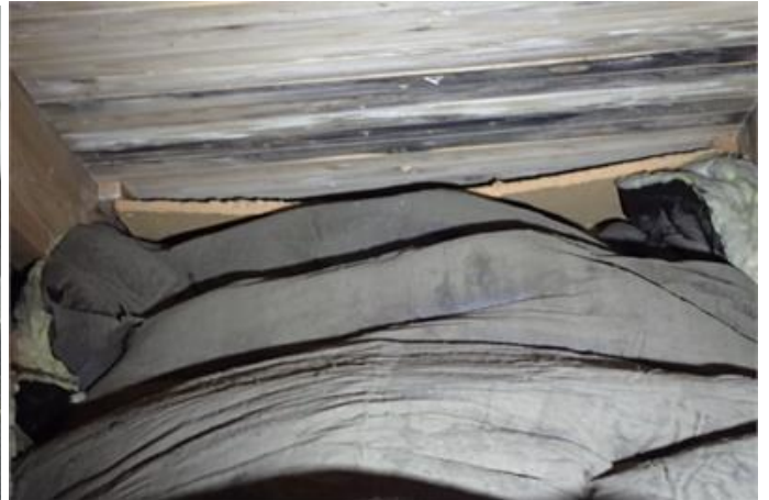
Mikrobiell påväxt på nockvindens underlagstak.
