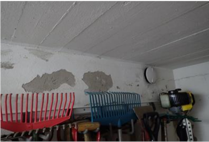
Putssläpp på grundmur i förråd.
