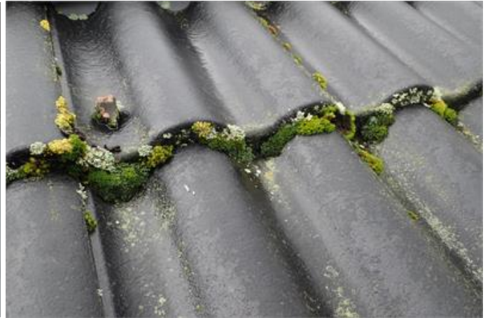
Mossa på betongpannor.
